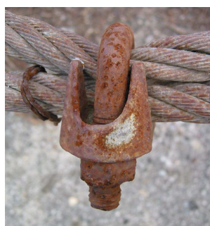
langsam verlaufende Oxidation
